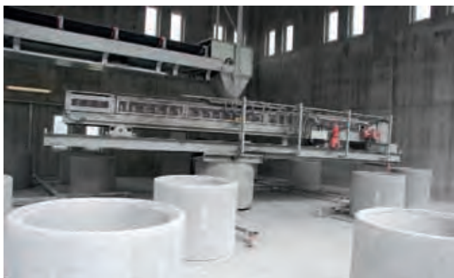
Zuschlagstoff-Verteilanlage für die 16 Silokammern im oberen Teil des Produktionsturms
