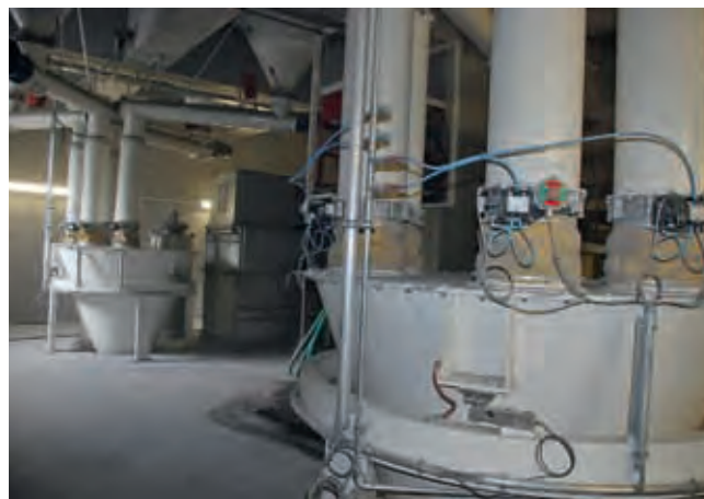
Das von Doubrava konzipierte Betonwerk weist zwei Produktionslinien auf und erreicht einen maximalen Betonausstoss von 200 m 3 /h
