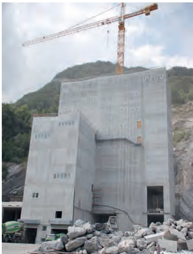
Am Schollberg bei Trübbach SG steht in einem 56 m hohen Betonturm ein neues Betonwerk mit zwei Produktionslinien in Betrieb.
