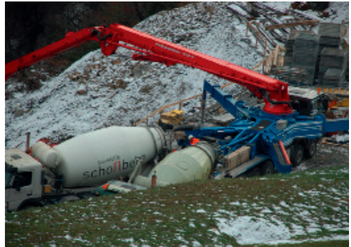
Vom Werk der Baustoffe Schollberg AG in Trübbach SG ist der Beton nach Eigenschaft aus gebrochener Gesteinskörnung und Low-Heat-Zement Modero B auf Fahrmischern zur Einbaustelle gefördert worden
