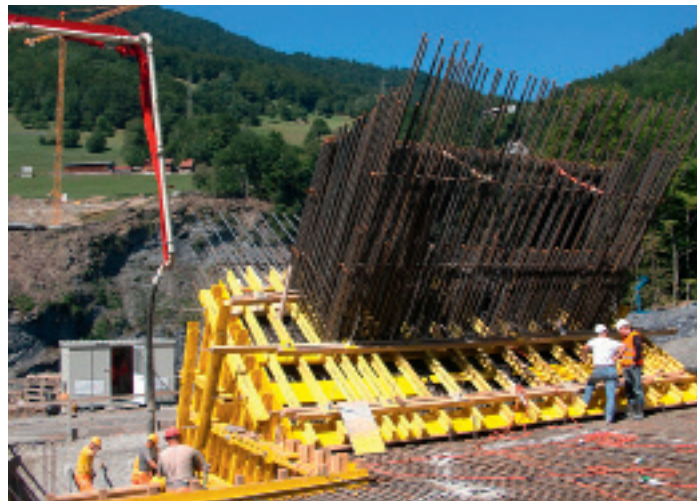
Der Einbau des Betonvolumens von 2'000 m 3 für den Kämpfer Pfäfers mit einer aussergewöhnlich dichten Bewehrung von 350 t erfolgte logistisch anspruchsvoll rund um die Uhr während 32 Stunden und erforderte 155 Fahrmischertransporte à 7 m 3
